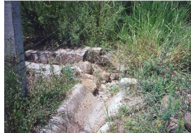
Toma granja en mal estado
