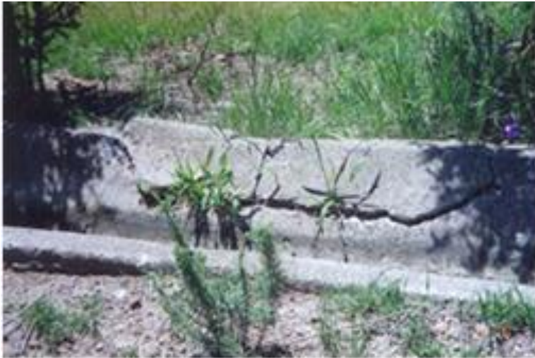
Losa dañada en talud de un canal lateral
