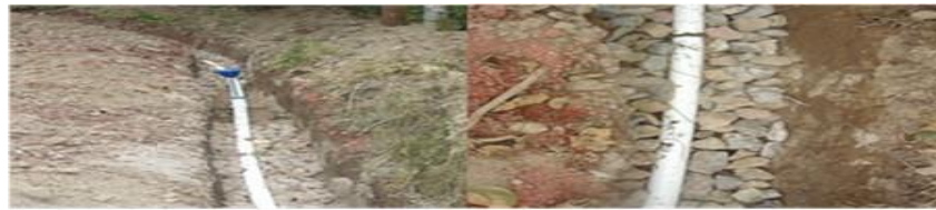
Figura 7. Red de tubería hidráulica sanitaria para la distribución de agua procedente del embalse, sembrada sobre grava para reducir golpe de ariete (fenómeno hidráulico transitorio producido por variaciones de velocidad en el fluido transportado).
