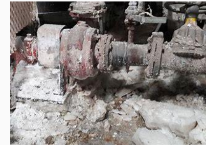
Corrosión de bombas
