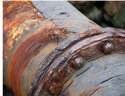
Corrosión de tuberías
