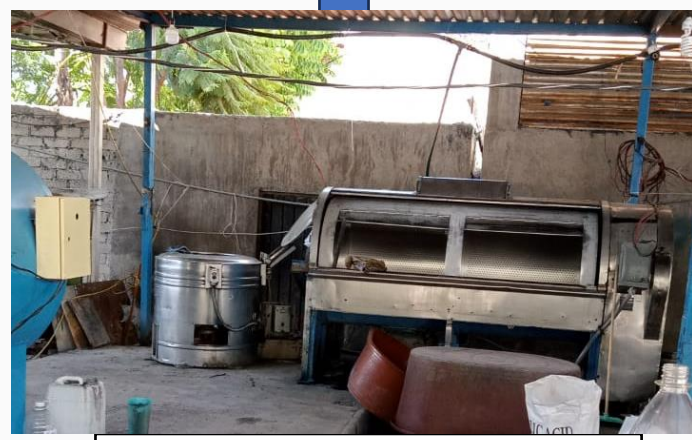
Ilustración 1. Máquina de proceso de lavandería, "ALEX PROCESOS Y LAVADOS"
