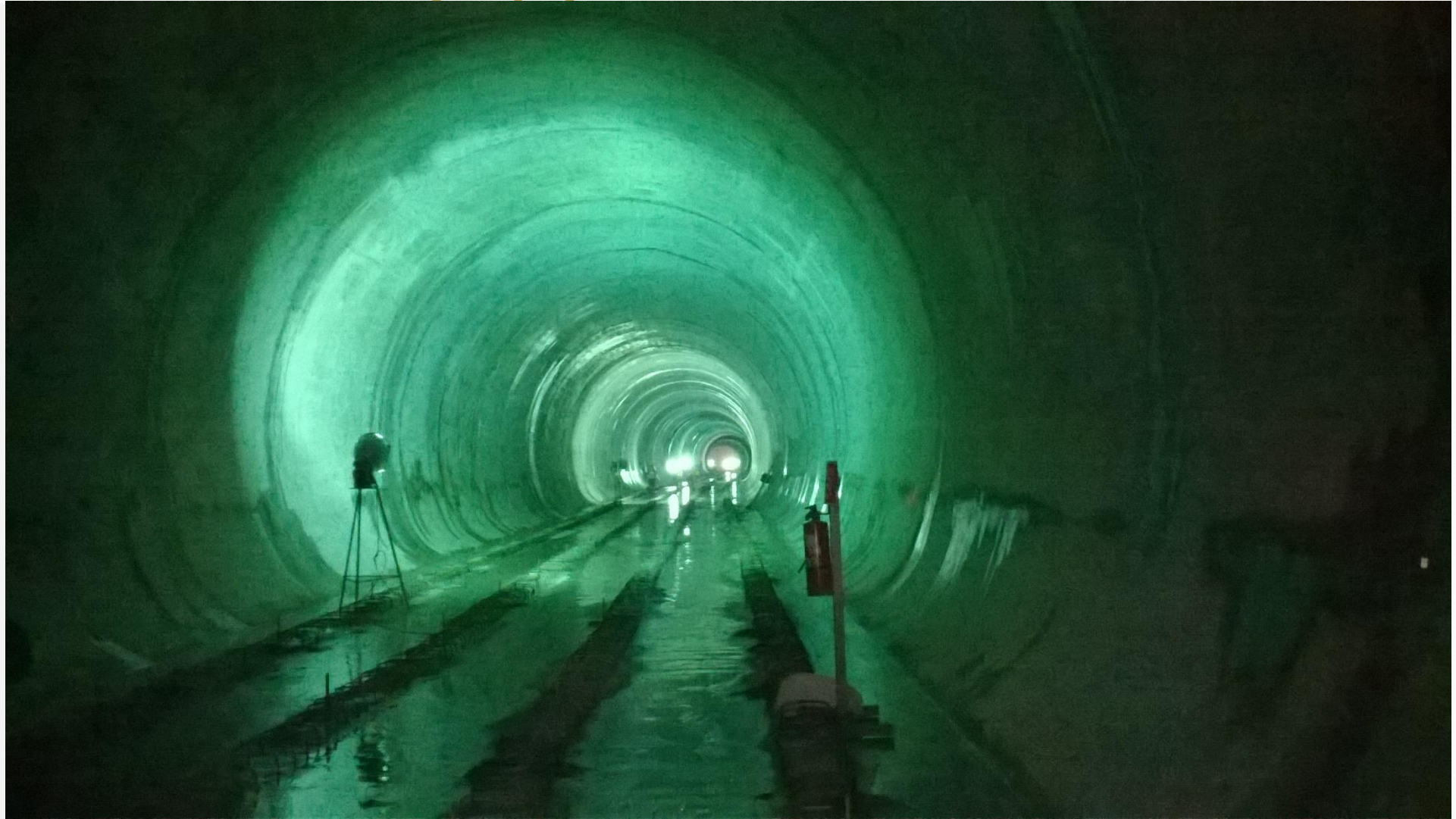
Mismo lugar de la imagen anterior solo que ya terminado el túnel, se detuvo el bombeo y el nivel del agua atrapo el túnel por completo, la iluminación es especial para encontrar las infiltraciones en las uniones del concreto
