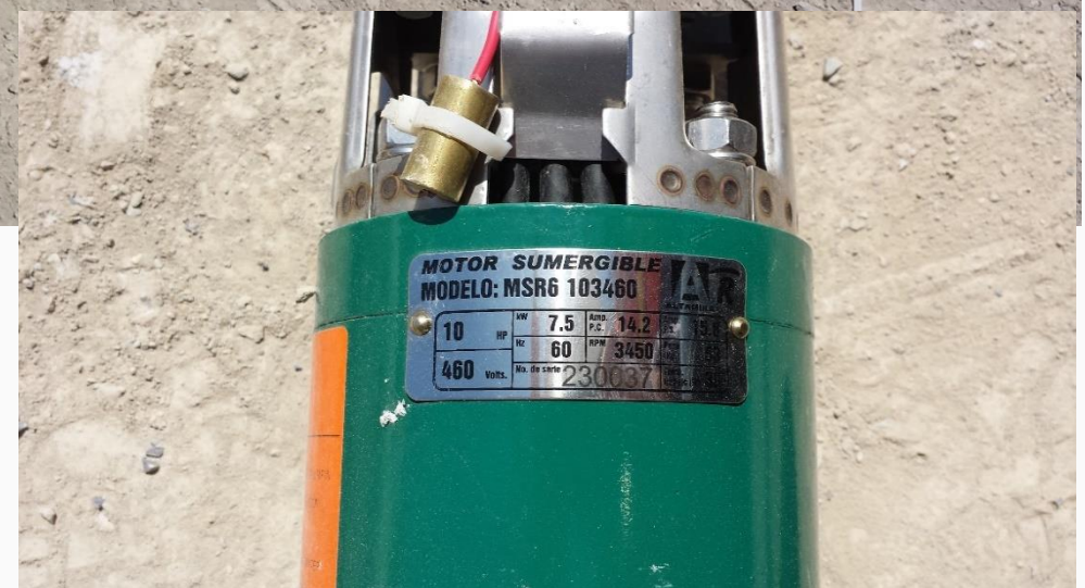
Una bomba sumergible de las 128 que se utilizaron en este proyecto, aquí se puede observar los dos bulbos sensores de humedad que generan la automatización en control de nivel
