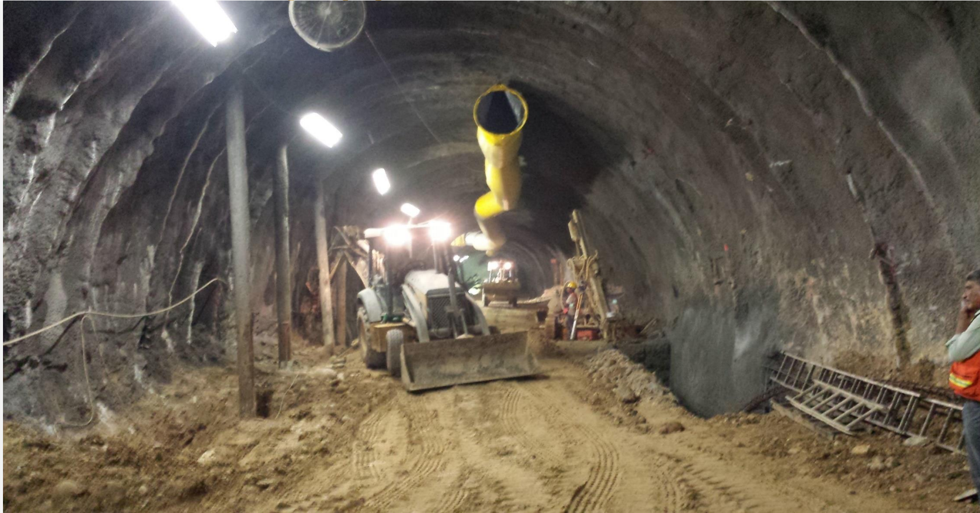
Imagen que describe el inicio de la construcción del túnel, de la línea del metro, así se puede observar el abatimiento gradual del agua y al extraer el material de relleno van quedando los ademes expuestos, todas las bombas están funcionando y continúan extrayendo gasto para permitir la extracción de material
