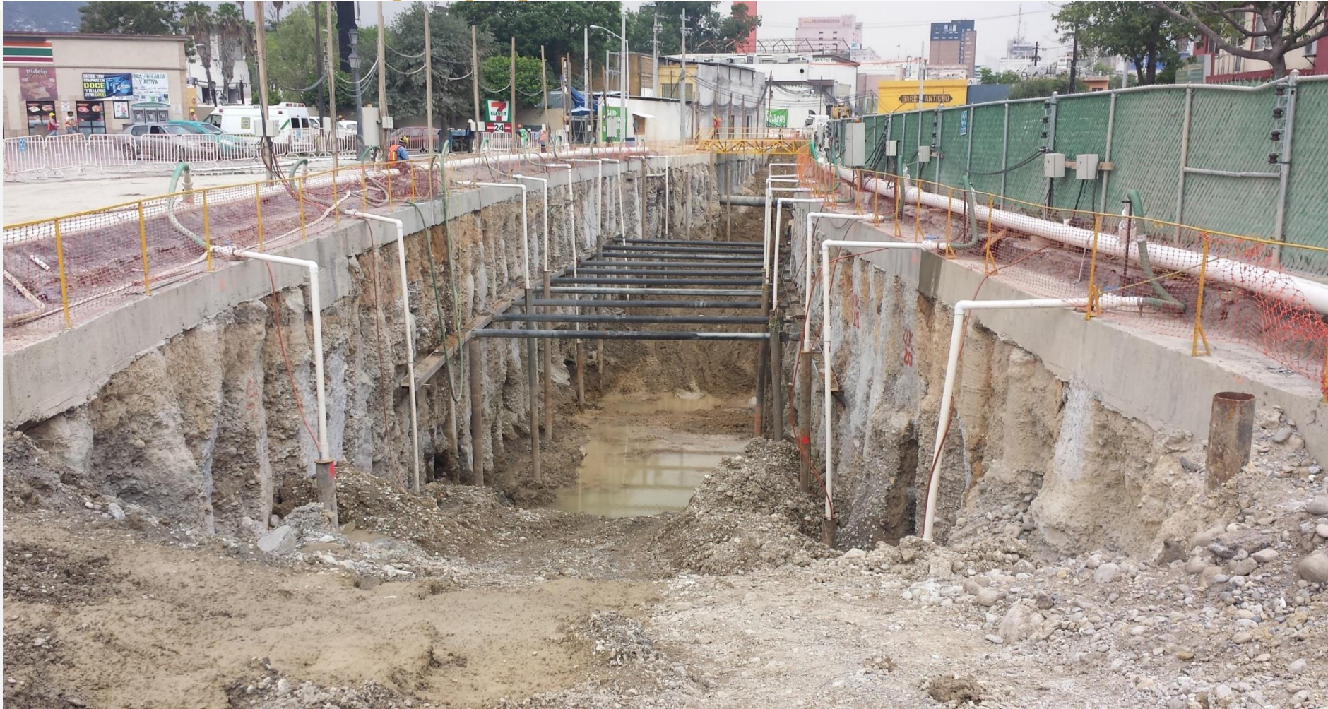
Vista de Oriente a Poniente de la calle Padre Mier frente a los multifamiliares Constitución, en donde se puede observar el inicio del bombeo y el frente freático, así como el arreglo de bombeo, se puede observar las descargas de las bombas, los controles eléctricos completamente automatizados, así como los muros de carga y la construcción de un amarre tipo BERLIN
