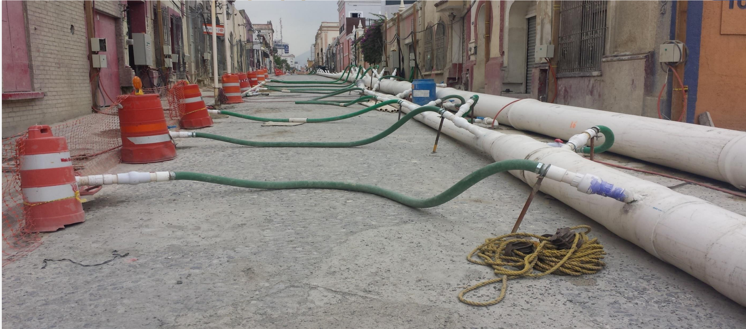
Imagen que describe la automatización de bombeo y las tuberías colectoras de gasto en paralelo de las bombas sumergibles en la calle Padre Mier, por debajo se presenta el túnel de la imagen anterior.
