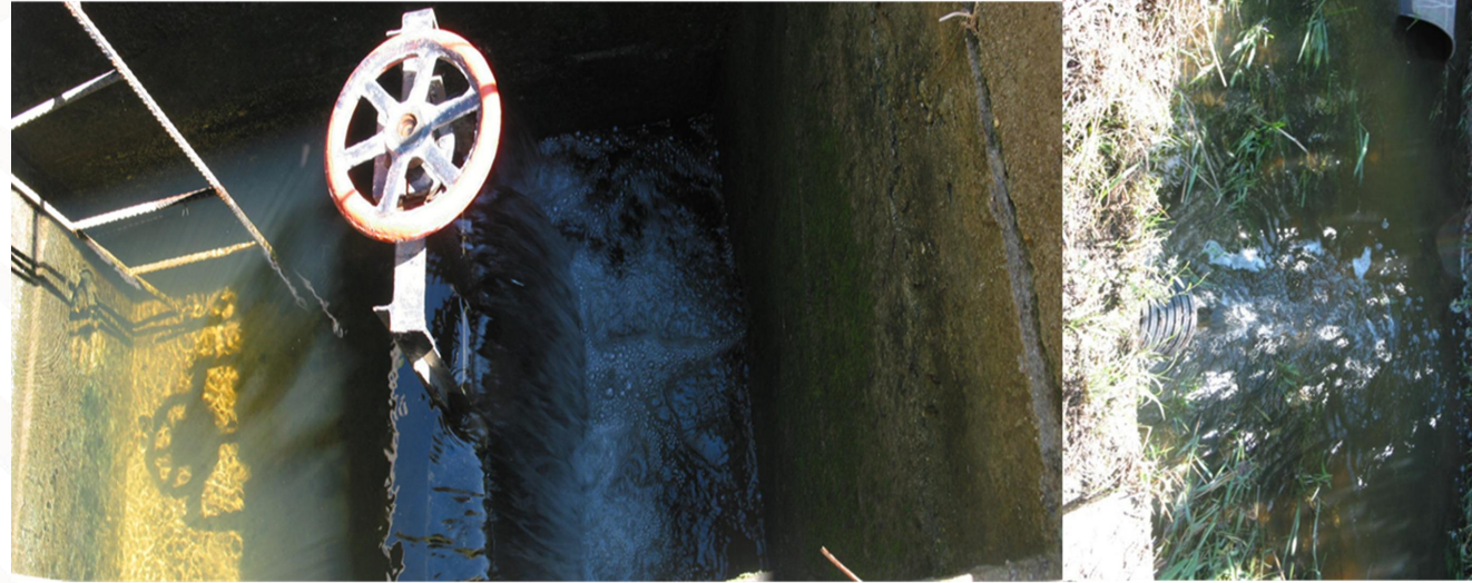
Estructura de control para manejo del nivel freático.
