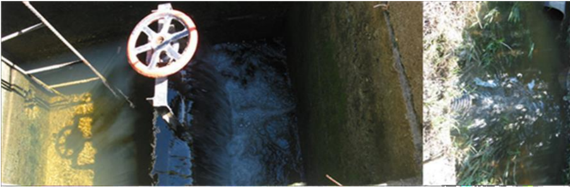
Figura 5. Estructura de control, para el manejo del régimen de humedad en el suelo.
