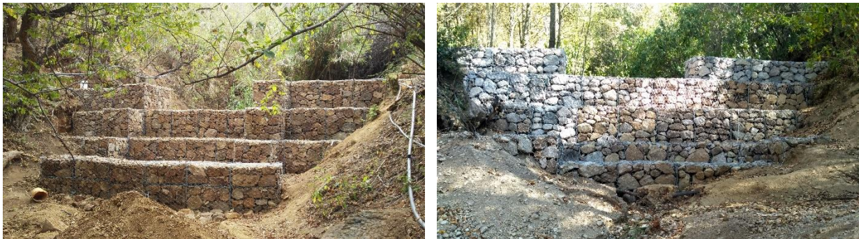
Figura 1. Aspecto de una presa de gaviones construida con fines de conservación de suelo y agua (Cortesía SITEA S.A. de C.V.).
